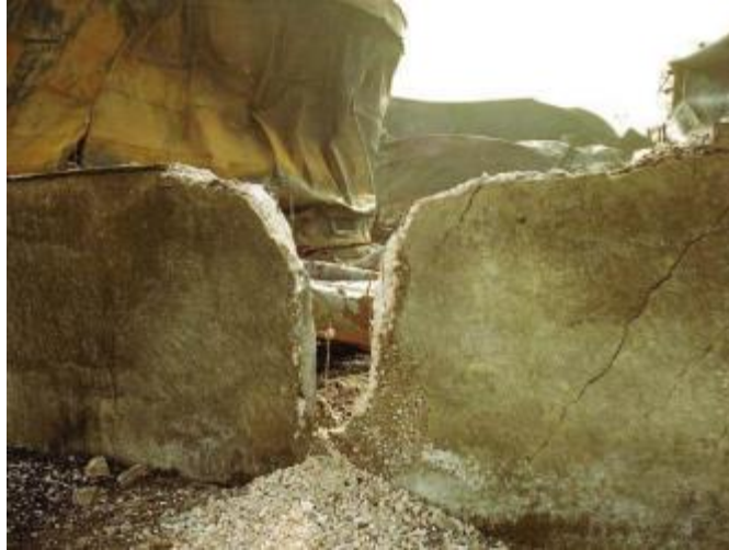
Figura 4: Fractura del muro de hormigón de un dique de contención (Buncefield Major Incident Investigation Board, 2006).
