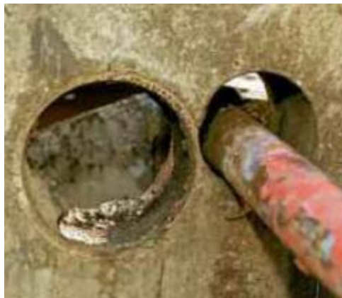
Figura 5: Agujeros en un dique de contención de hormigón para el paso de tuberías. El material sellante se había consumido (Buncefield Major Incident Investigation Board, 2006).
