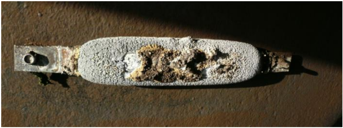
Figura N°3: Ánodo de sacrificio
