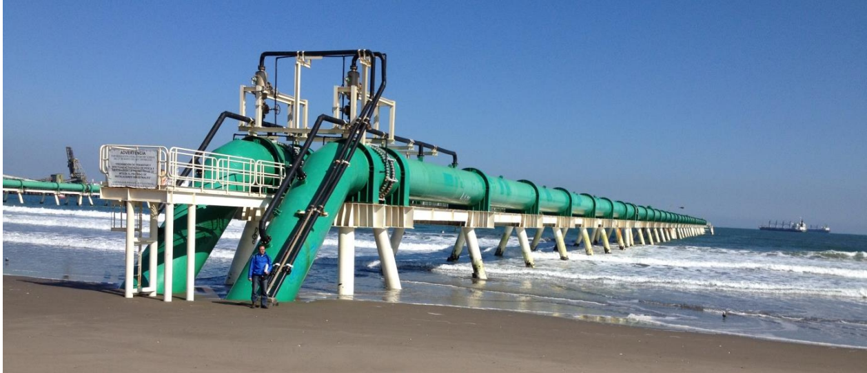
Ilustración 81: Sifón de captación de agua de refrigeración para la central termoeléctrica de AES GENER, en la bahía de Quintero.
